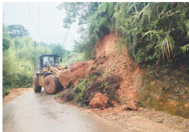
因暴雨影响,德化县的一些乡村道路出现溜方等轻微灾情。图为7日下午,德化县龙门滩镇组织工程车辆清理震碧村道路溜方。 童越 李向娟 摄
