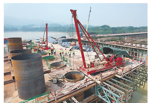
日前,国道G324线龙海角美大跨径至龙文朝阳滨滨段公路工程项目A2标段滨滨特大桥主墩首根水中桩基顺利开孔,标志着项目建设步入新阶段。
