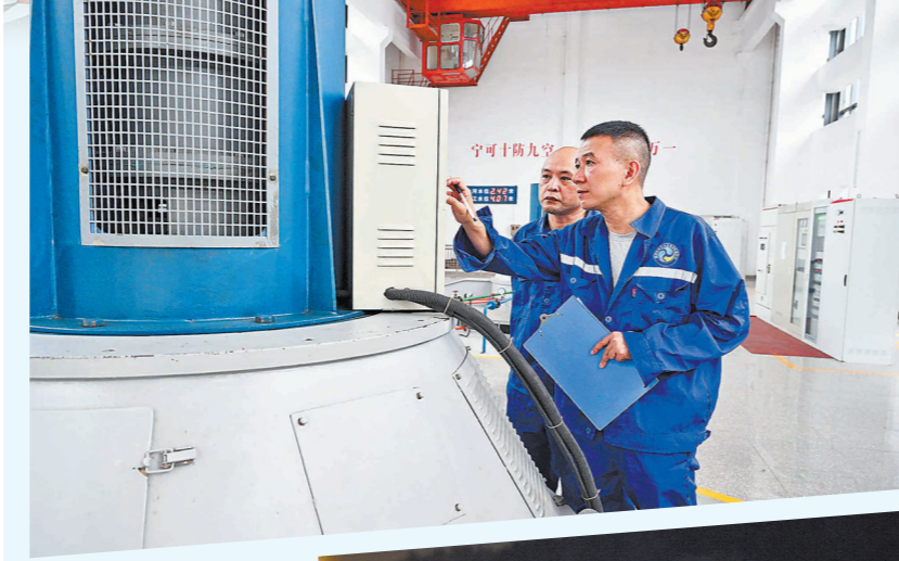
▲27日,为应对台风带来的强降雨,福州市城区水系联排联调中心鳌岐排涝站技术人员加紧对排涝设备进行巡查。 吴恩儿 摄
