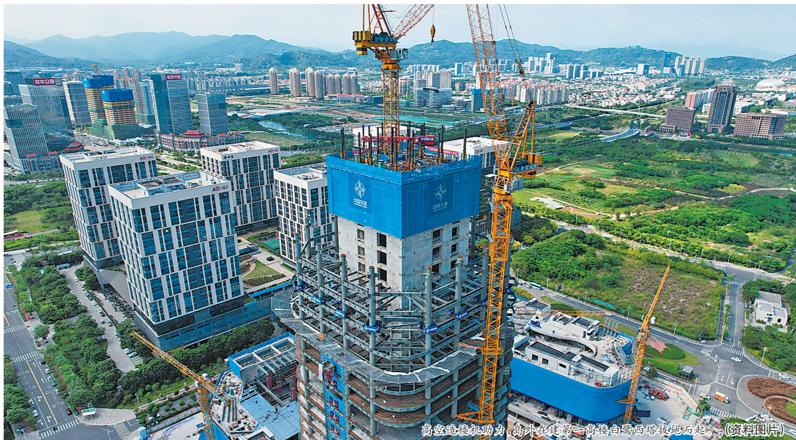
高空造楼机助力,海外在建第一高楼白鹭西塔拔地而起。(资料图片)
