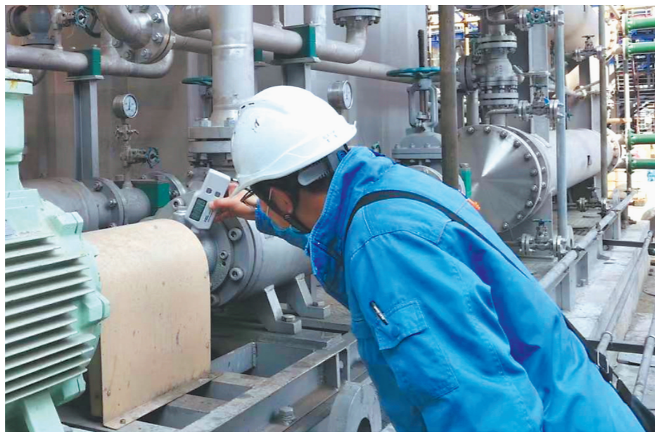
王浩用测温枪对机泵进行测温,防止机泵运转时产生过高温。
