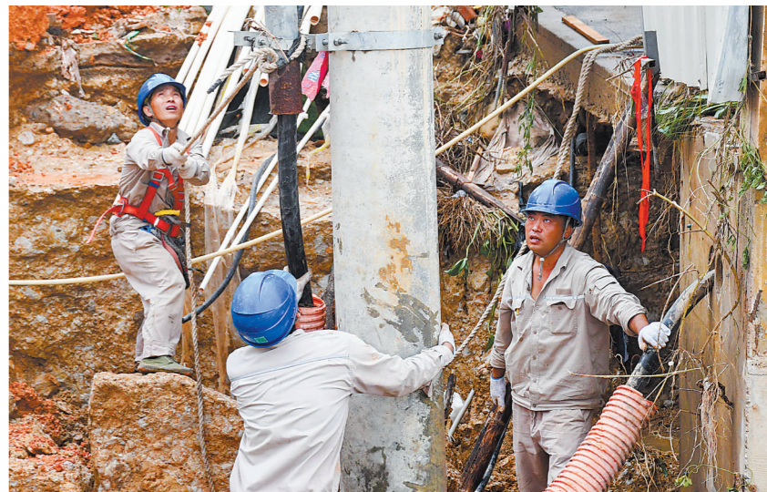
5日,国网福州供电公司在福清抢修10千伏虎区线倒杆。 游庆辉 陈蒸 摄
