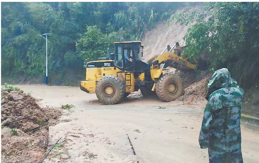
5日,德化县龙门滩镇预置队伍在礁坑村清理塌方。 彭朱伟 李向娟 摄
