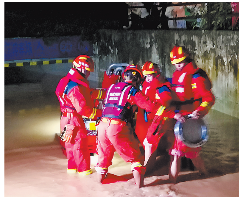
6日晚,来自省消防救援总队福州支队特勤大队二站和国网福建电力共产党员服务队的抢险人员在福州鼓楼庭院、大儒世家小区地下室车库排水清淤。
