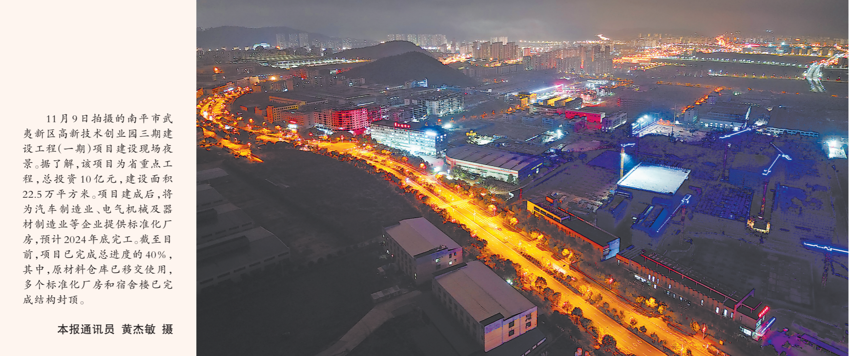
11月9日拍摄的南平市武夷新区高新技术创业园三期建设工程(一期)项目建设现场夜景。据了解,该项目为省重点工程,总投资10亿元,建设面积22.5万平方米。项目建成后,将为汽车制造业、电气机械及器材制造业等企业提供标准化厂房,预计2024年底完工。截至目前,项目已完成总进度的40%,其中,原材料仓库已移交使用,多个标准化厂房和宿舍楼已完成结构封顶。
