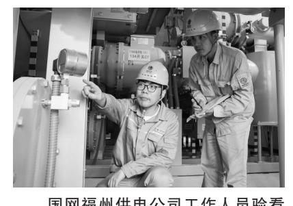
国网福州供电公司工作人员查看220千伏塘头变110千伏的GIS设备。
