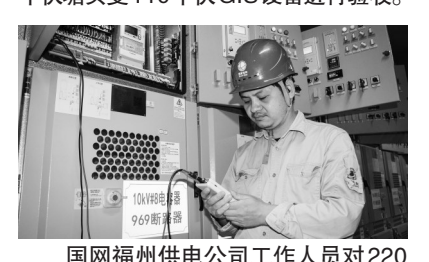
国网福州供电公司工作人员对220千伏塘头变10千伏开关室进行验收。
