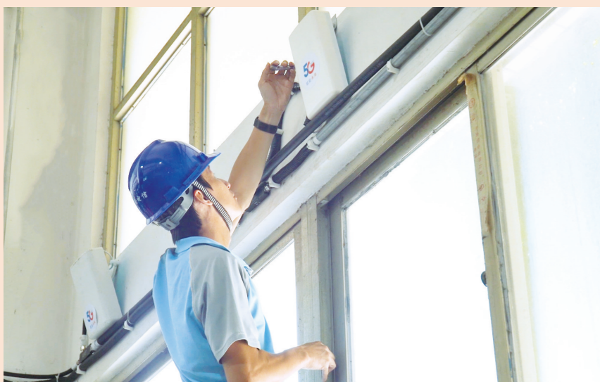
厂区5G室分设备调测
