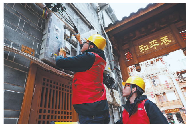
为保障居民用火用电安全,宁化县翠江镇政府与国网宁化供电公司成立党员服务队,对辖区划片分区,设立“党员片长”。古民居居民可通过微信群、电话与片长沟通,问题当日解决。图为25日,供电公司工程师接到居民反映后立即对电路进行维修。 陈凯 摄
