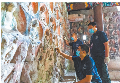
右图:大足石刻宝顶山小佛湾摩崖造像保护修缮工程进入本体修复阶段。(资料图片)
