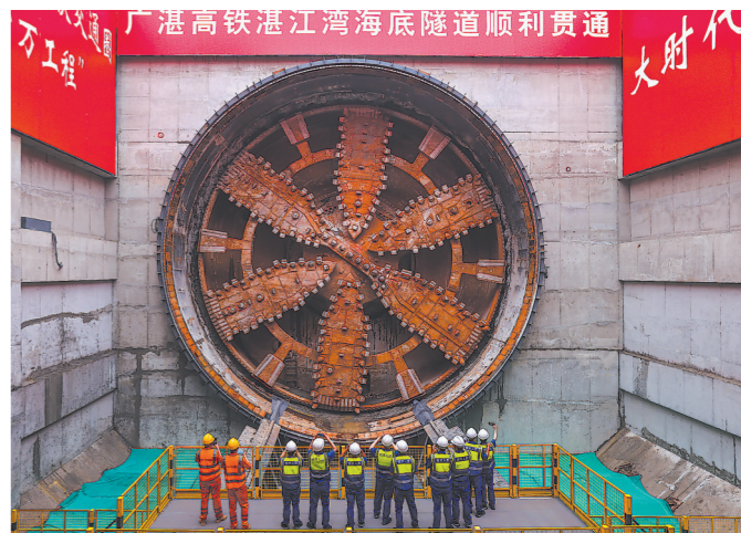
3月15日,建设者在广湛高铁湛江湾海底隧道盾构接收井见证隧道贯通。
