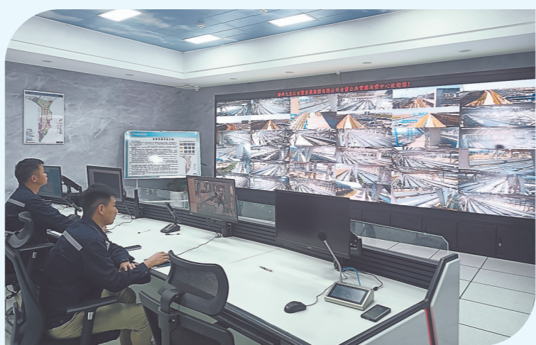
古雷石化园区公共管廊中控室 (资料图片)
