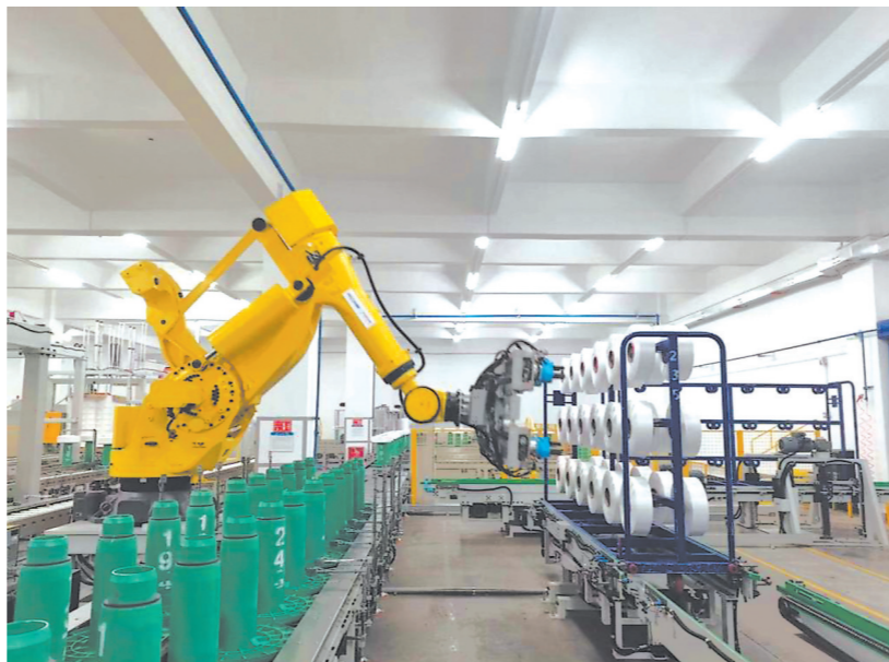
恒申前纺三期自动包装线项目的自动卸丝环节 本报记者 林蔚 摄
