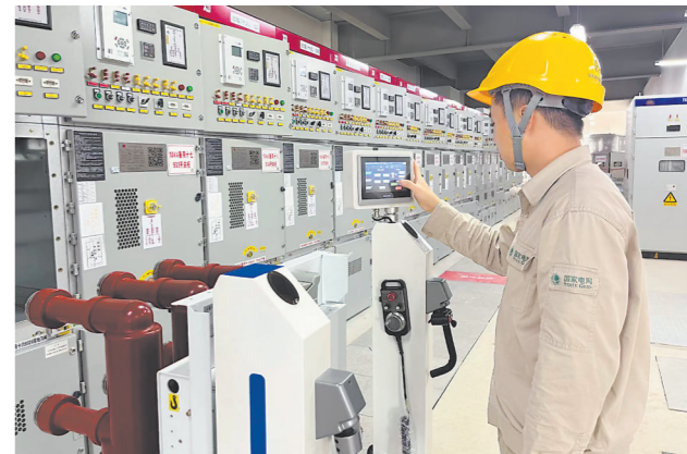
国网福建电力科学研究院通过专利转化,将传统转运小车升级。图为变电运维中心工作人员在操作智能转运车。
