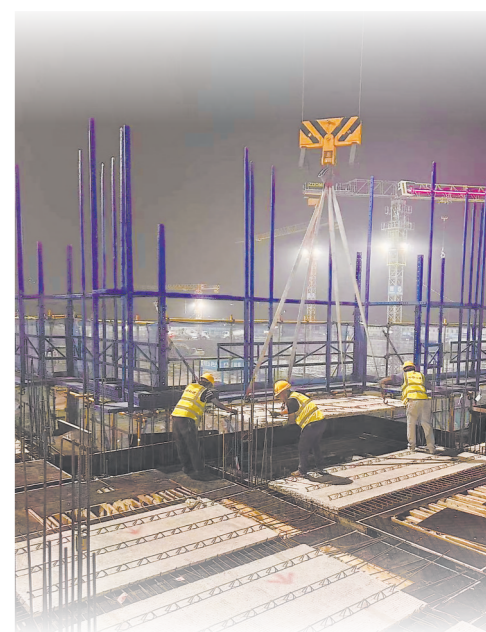
在泉州田中里项目施工现场,工人进行装配式建筑的吊装施工。 本报通讯员 许盼盼 摄
