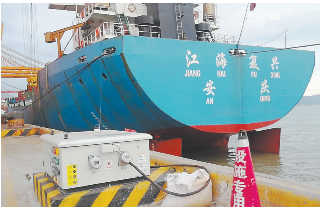
靠泊在厦门港的船舶连接上岸电。
