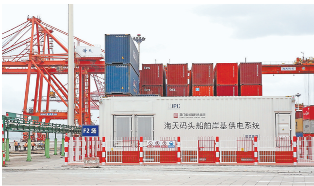
厦门港海天码头的岸电系统
